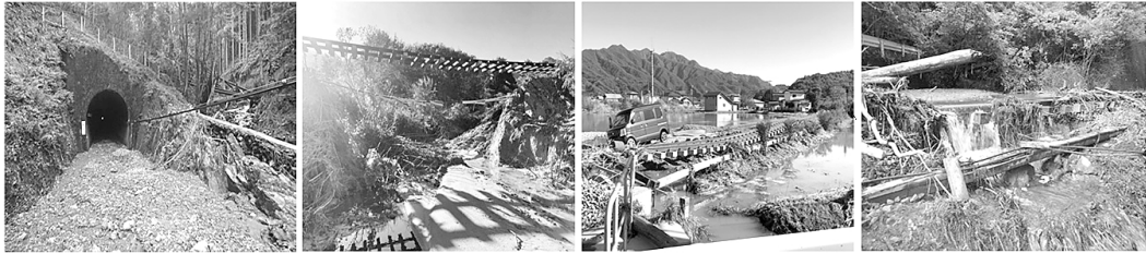
①土砂流入 釜石トンネル (釜石駅～両石駅間) ②路盤流出 (岩手船越駅～織笠駅間) ③第1釜石街道踏切付近 (払川駅～津軽石駅間) ④土砂流入・道床流出 (普代駅～白井海岸駅間)
