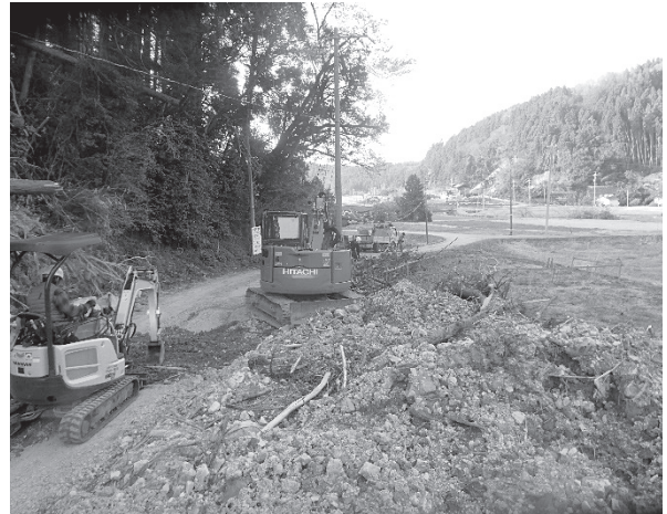
図1のE地点、南志見川下流部の谷壁斜面の崩壊により通行不能になった道路の修復作業風景
