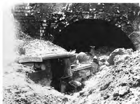
トンネル出口での土砂災害
