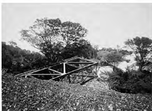
山津波で埋没した白糸川橋梁※
