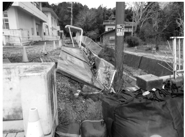
みさき小学校の被害(珠洲市)
