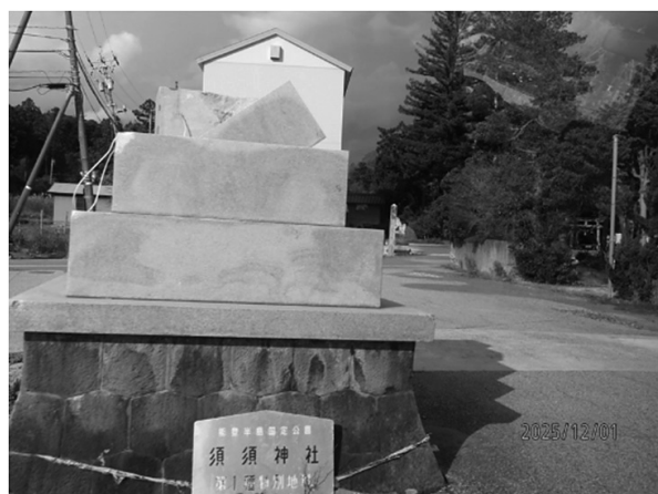
須須神社の被害(珠洲市)
