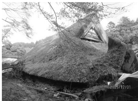
上時国家の主屋の被害(輪島市)
